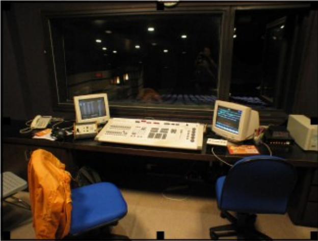
專業劇場裡的燈光控制室
